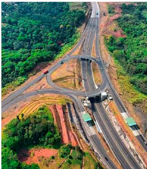
Figura 143 Vista panorámica del segundo tramo de la Autopista Panamá – Colón, entronque hacia Quebrada López
